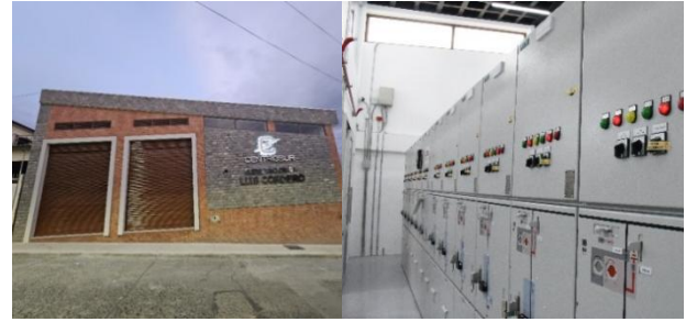
Vista frontal de la SE 01 Equipamiento de la SE 01
