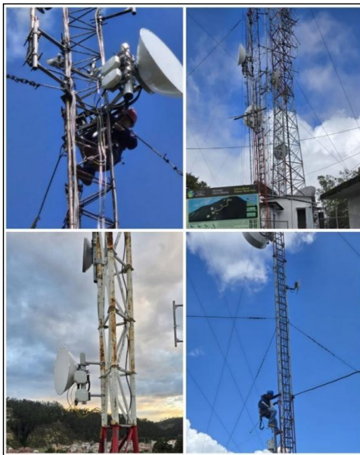
Implementación de radioenlaces en Centrosur
