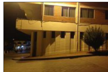
Adecantamiento fachada SE 2
