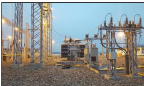
Bahía de transformador de 20/25 MVA, S/E 50 - La Troncal
