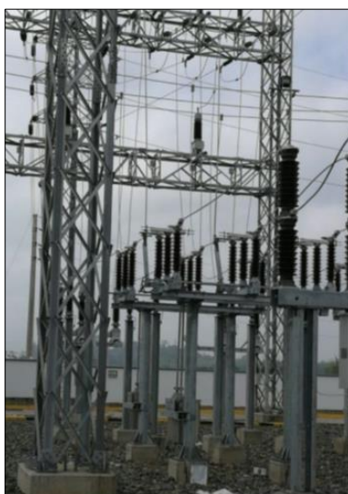
Bahía de 69 kV a Puerto Inca, en la SE 50, La Troncal
